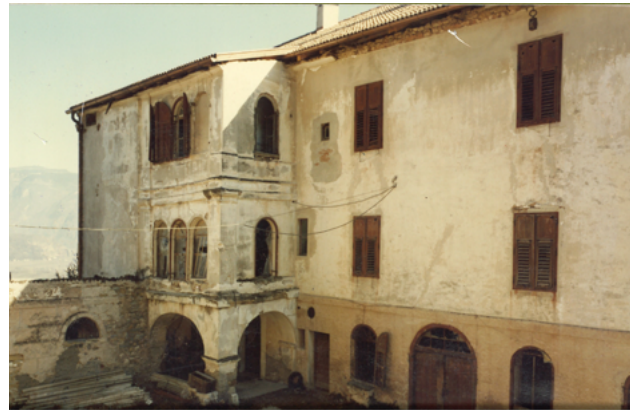
Das Hauptgebäude im desolaten Zustand
