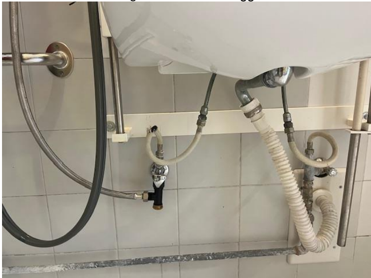
Il flessibile che ha ceduto provocando la perdita
