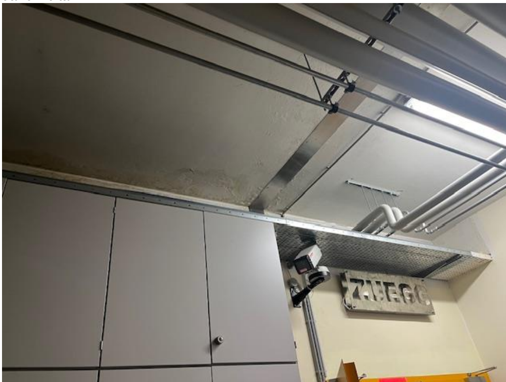
Il corridoio d'accesso al laboratorio con i danni a soffitto causati dall'acqua intrisa nel solaio
