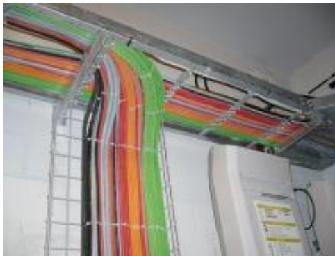
Kabeltrasse im Stadion für die Erschliessung der verschiedenen Standorte
