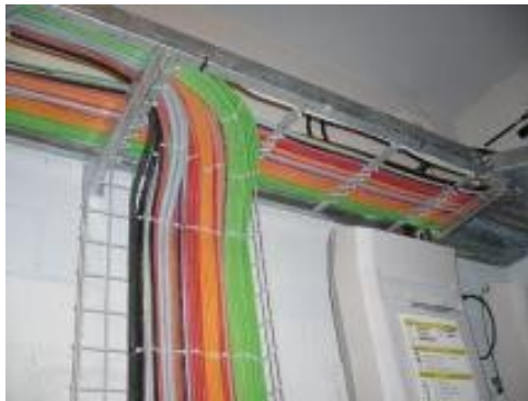
Kabeltrasse im Stadion für die Erschliessung der verschiedenen Standorte
