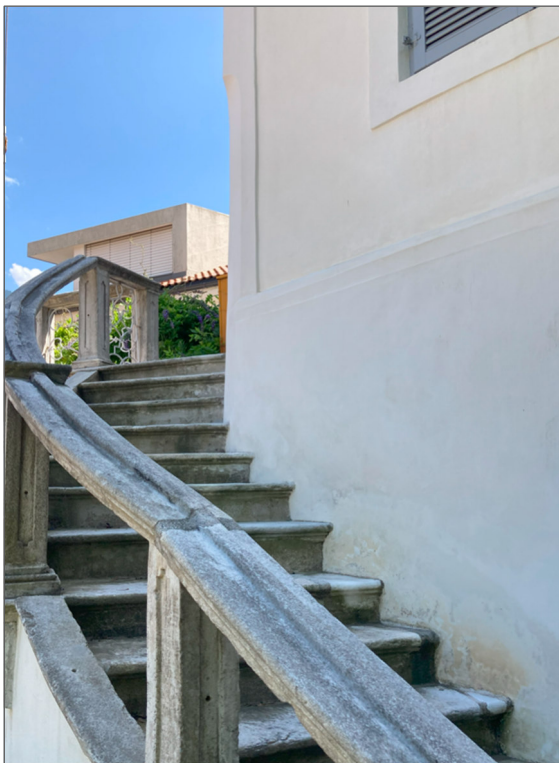
Foto 29 Blick Treppe 1 | Vista scala 1
