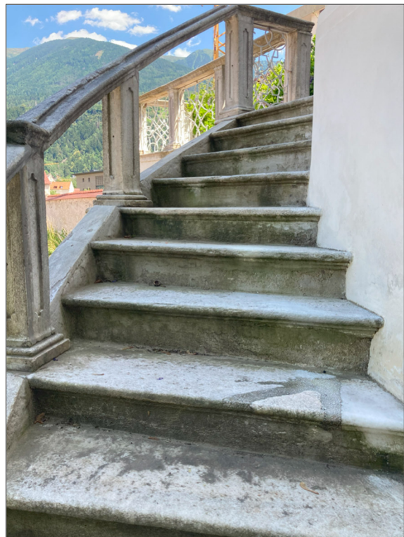
Foto 30 Blick Treppe 2 | Vista scala 2
