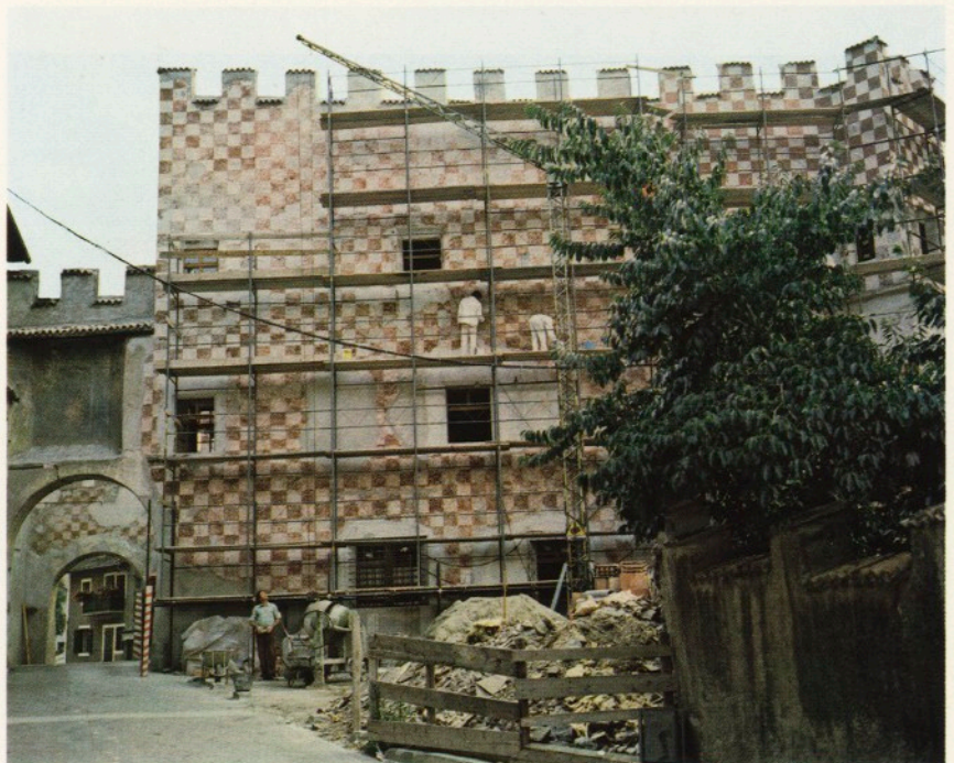
Barbian/Kollmann — Zollhaus außen. Das stark verfallene Gebäude wurde 1979—1980 vom neuen Eigentümer saniert; vom Denkmalamt werden die Fassaden restauriert.
