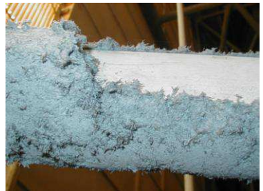
Rivestimento in amianto spruzzato
