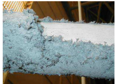
Rivestimento in amianto spruzzato
