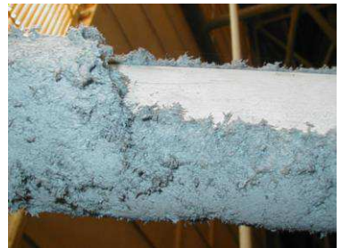
Ummantelung aus Spritzasbest
