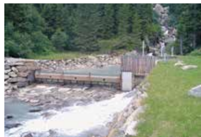
63. Opera di presa dell'impianto idroelettrico sul rio Ferner.
