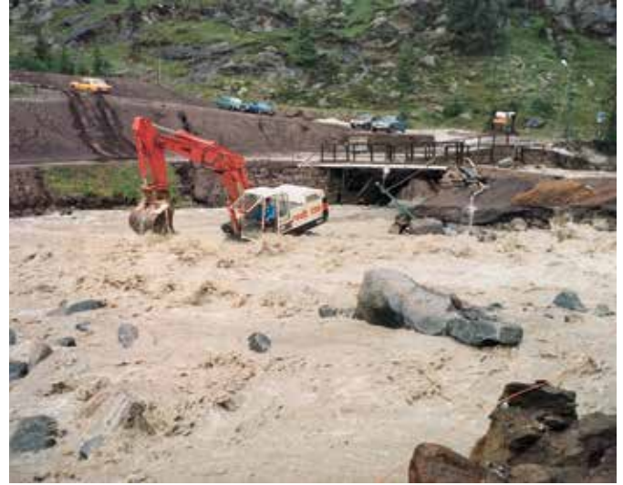
61. Einsatz in Maiern während des Hochwassers vom Juli 1987.
