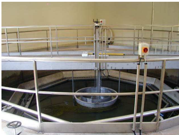
Innendetail der Anlage, Laurein (Foto: Amt für Gewässerschutz)
