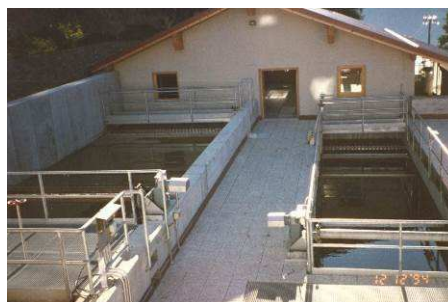
Detail der Anlage, Unterinn (Foto: Amt für Gewässerschutz)
