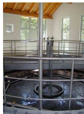
Innendetail der Anlage, Proveis (Foto: Amt für Gewässerschutz)
