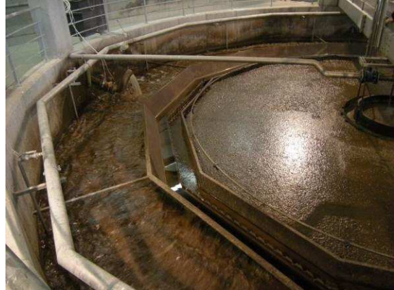
Detail der Anlage, Mölten (Foto: Amt für Gewässerschutz)
