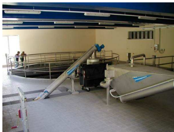
Detail der Anlage, Matsch (Foto: Amt für Gewässerschutz)
