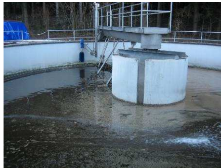
Detail der Anlage, Sarntal (Foto: Amt für Gewässerschutz)
