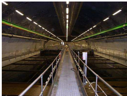
Detail der Anlage, St. Lorenzen (Foto: Amt für Gewässerschutz)
