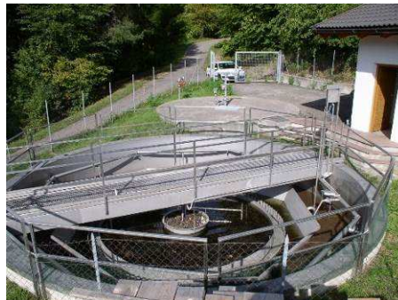
Detail der Anlage, Afing (Foto: Amt für Gewässerschutz)
