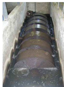
Detail der Anlage, St. Pankraz (Foto: Amt für Gewässerschutz)
