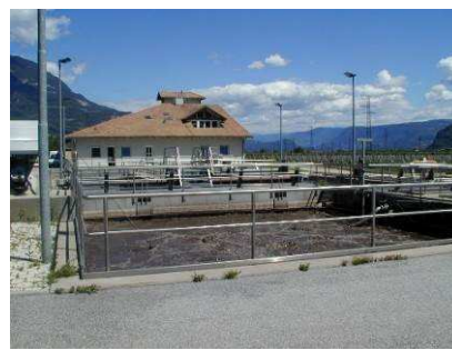
Detail der Anlage, Margreid (Foto: Amt für Gewässerschutz)
