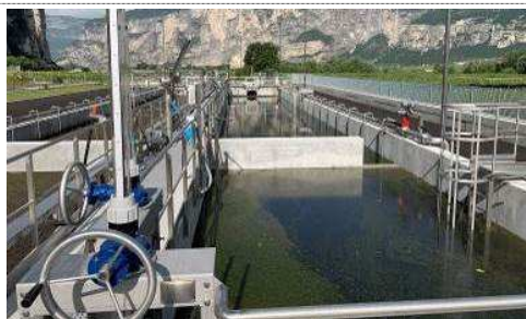
Detail der Anlage, Salurn (Foto: Amt für Gewässerschutz)
