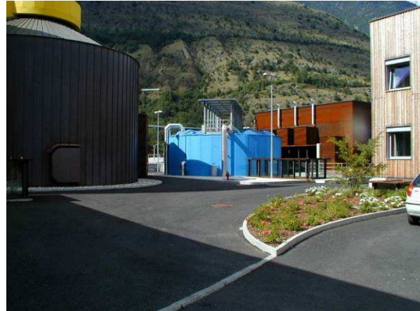
Detail der Anlage, Mittelvinschgau (Foto: Amt für Gewässerschutz)
