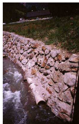
Ableitungsstelle der Anlage, Schnals (Foto: Amt für Gewässerschutz)
