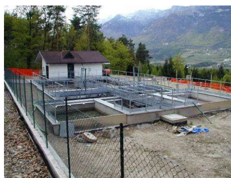
Detail der Anlage, Montiggl (Foto: Amt für Gewässerschutz)
