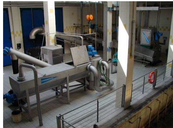
Detail der Anlage, Prader Sand (Foto: Amt für Gewässerschutz)
