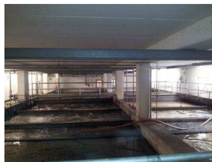
Innendetail der Anlage, Lügen (Foto: Amt für Gewässerschutz)
