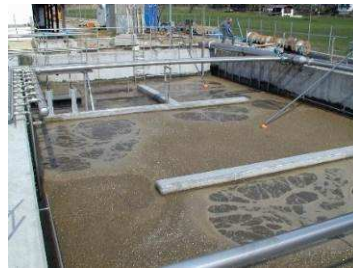
Detail der Anlage, Passeier (Foto: Amt für Gewässerschutz)
