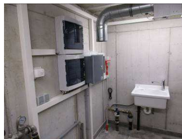
Immagine dell'impianto di depurazione
