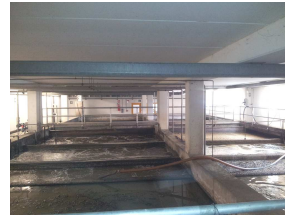
Kläranlage Abbildung (Foto Bezirksgemeinschaft Eisacktal)
