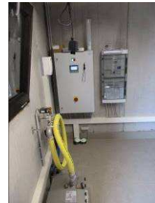
Immagine dell'impianto di depurazione
