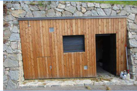
Immagine dell'impianto di depurazione
