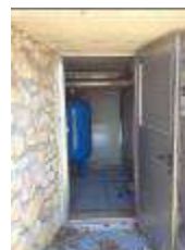
Immagine dell'impianto di depurazione
