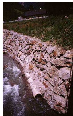
Punto di scarico impianto, Senales (foto Ufficio Tutela acque)
