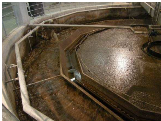
Particolare interno impianto, Meltina (foto Ufficio Tutela acque)
