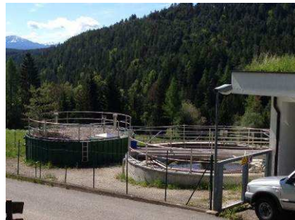
Particolare impianto, Valas (foto Ufficio Tutela acque)
