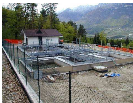
Particolare impianto, Monticolo (foto Ufficio Tutela acque)
