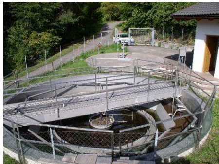
Particolare impianto, Avigna (foto Ufficio Tutela acque)
