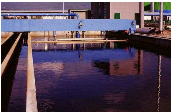
Particolare impianto, Bolzano (foto Ufficio Tutela acque)
