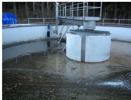
Particolare impianto, Sarentino (foto Ufficio Tutela acque)
