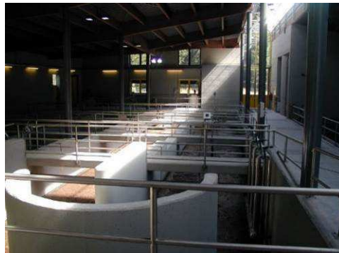
Particolare impianto, Ultimo (foto Ufficio Tutela acque)
