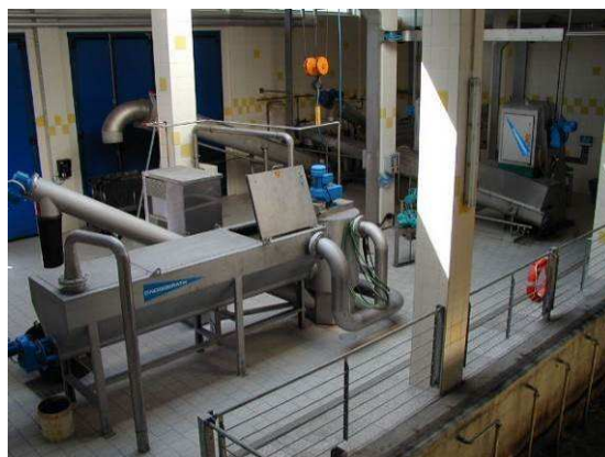
Particolare impianto, Prader Sand (foto Ufficio Tutela acque)
