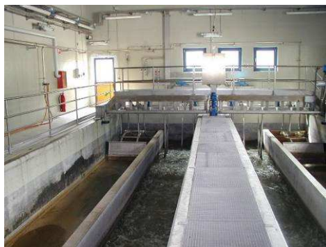
Particolare interno impianto, Wipptal (foto Ufficio Tutela acque)
