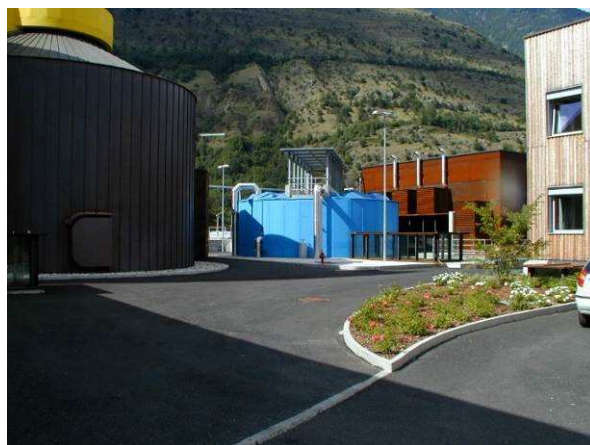
Particolare impianto, Media Val Venosta (Ufficio Tutela acque)
