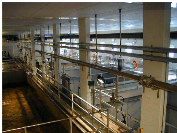
Particolare impianto, Solda (foto Ufficio Tutela acque)
