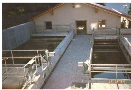
Panoramica impianto, Auna di Sotto (foto Ufficio Tutela acque)
