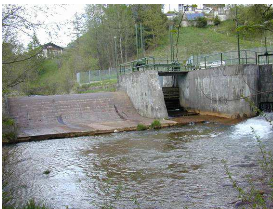
Abb. 30 Wasserableitung für die Stromerzeugung
