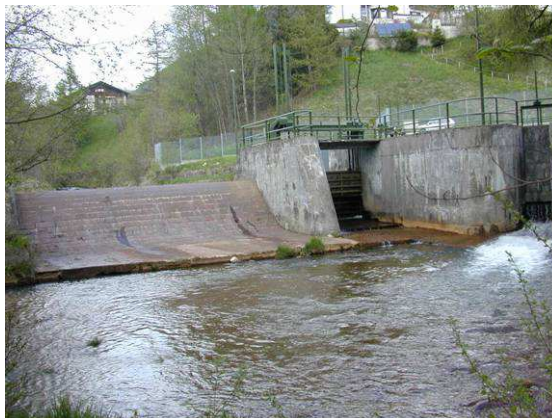
Fig. 30 Opera di derivazione per impianto idroelettrico
