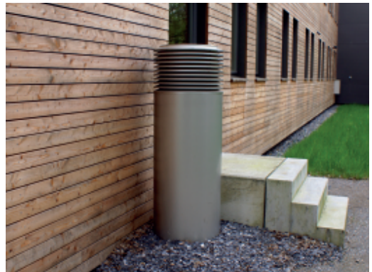
Ansaugöffnung für mechanische Zuluftanlage.
