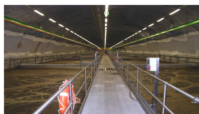
Immagine dell'impianto di depurazione
