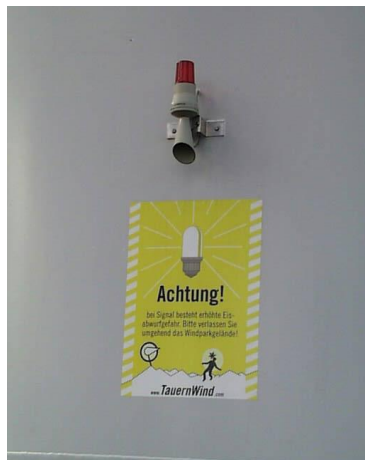
Figura 15 - Segnalatore di sicurezza luminoso ed acustico posto all'esterno dell'aerogeneratore.
