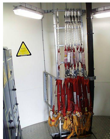
Figura 17 - Dotazioni di sicurezza all'interno della torre dell'aerogeneratore.
