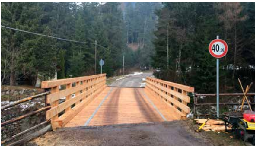
Auch viele Brücken sind in die Jahre gekommen und müssen an die erhöhten Belastungsanforderungen angepasst werden.
