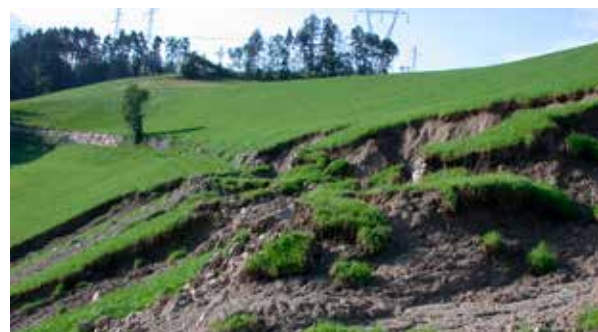
Erdbeben, Abbruch der Stützmauer und des Feldweges ...
