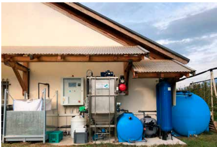
Abb. 4: Chemisch-physikalische Pilotanlage für größere Wassermengen
