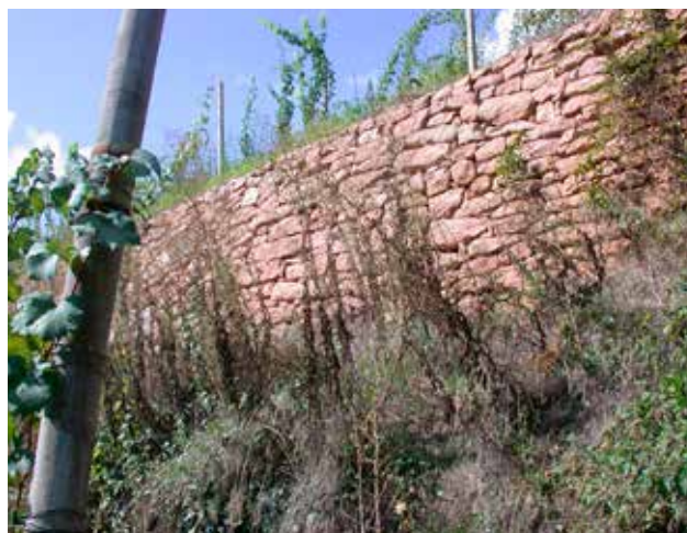
... und nach der Behebung des Unwetterschadens.
