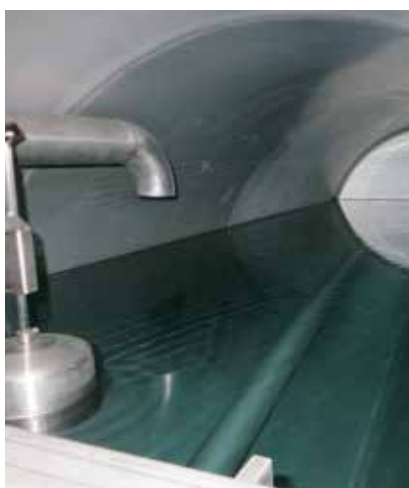
Trinkwasserspeicher in INOX
