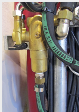
È necessaria la pulizia automatica dell'interno del filtro a pressione.
