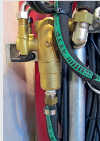
Eine automatische Innenreinigung des Druckfilters ist notwendig.
