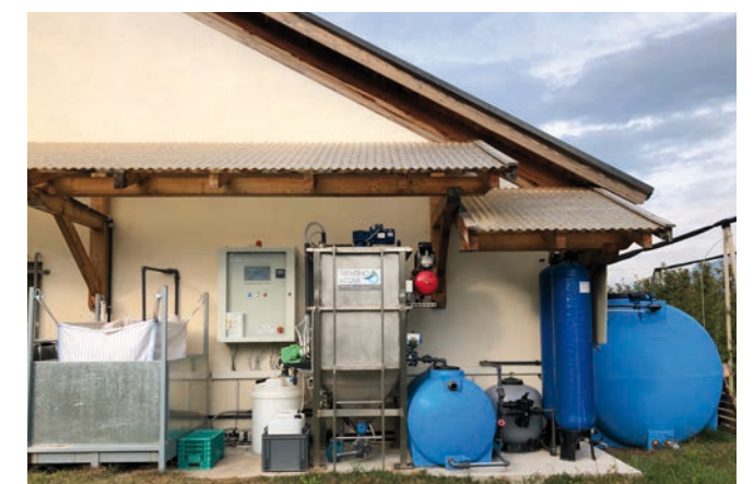
Chemisch-physikalische Pilotanlage für größere Wassermengen
