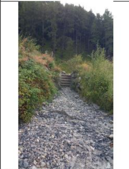
Abb. 5 – Überlauf des Rückhaltebeckens
