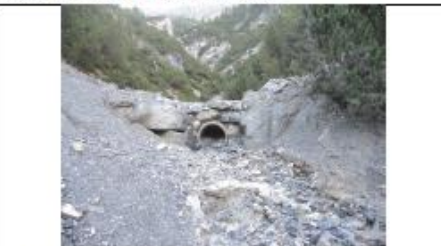
Abb. 4 – Mittlerer Bereich des Murkanals mit verstopftem Durchlass
