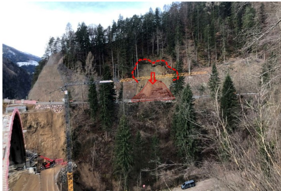
Ansicht der Rutschung nach SW, links im Bild die Brücke Eschenlohe, 12.3.2024 vista della frana verso SW, a sinistra il ponte Eschenlohe, 12.3.2024
