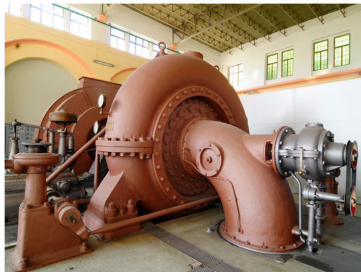
La centrale di Cardano
