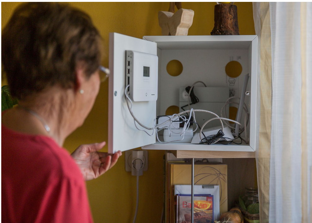
Das „Hirn“ des gesamten Projektes: In der zentralen Steuerungseinheit laufen die digitalen Fäden von gAALaxy zusammen, hier erfolgt im Alarmfall die Rückkoppelung mit den unterschiedlichen Teilsystemen.
