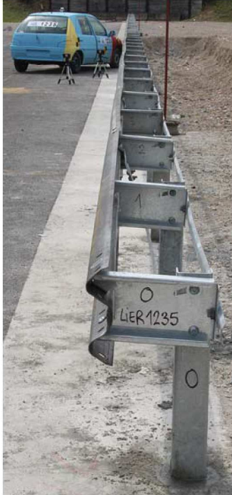
Vue générale du dispositif
