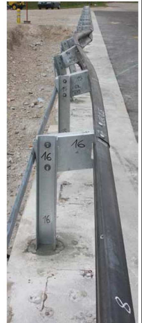
Danni sul dispositivo
