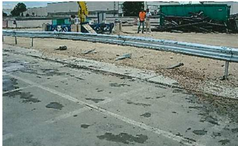
Plasticizzazione alla base dei montanti
