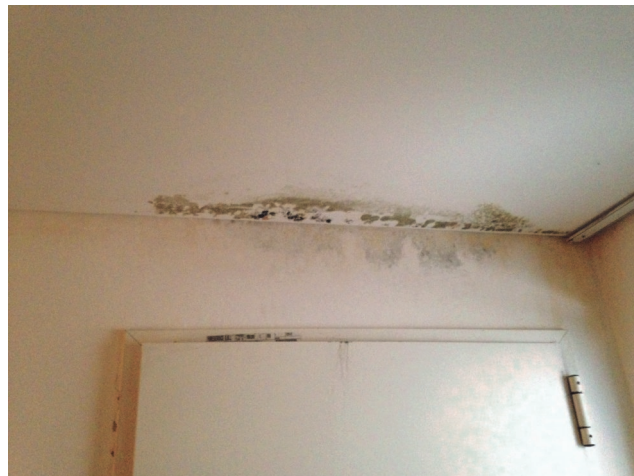
Durch unzureichendes Lüften wird die Schimmelbildung gefördert.
