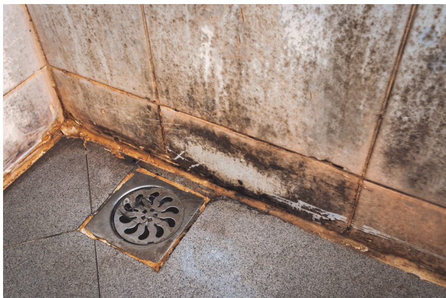
Muffa in un bagno del quale non si ha avuto cura di evitare l'umidità.
