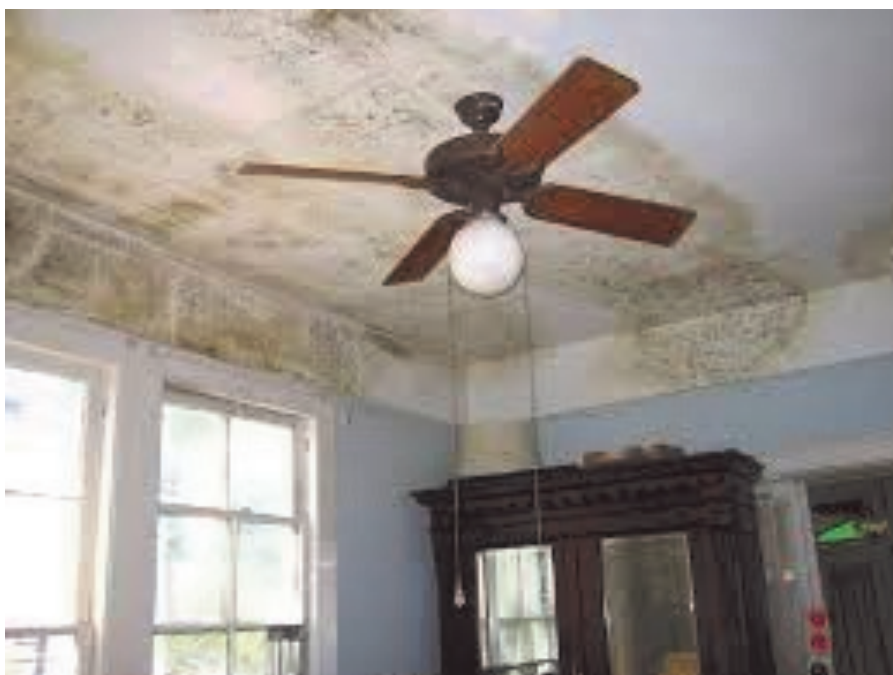
Alloggio mal areato con comparsa di muffa.
