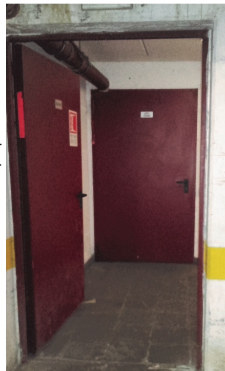
Esempio di una porta tagliafuoco aperta in modo errato.
