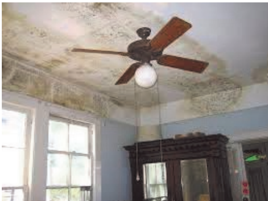
Schlecht gelüftete Wohnung mit Schimmelbefall.
