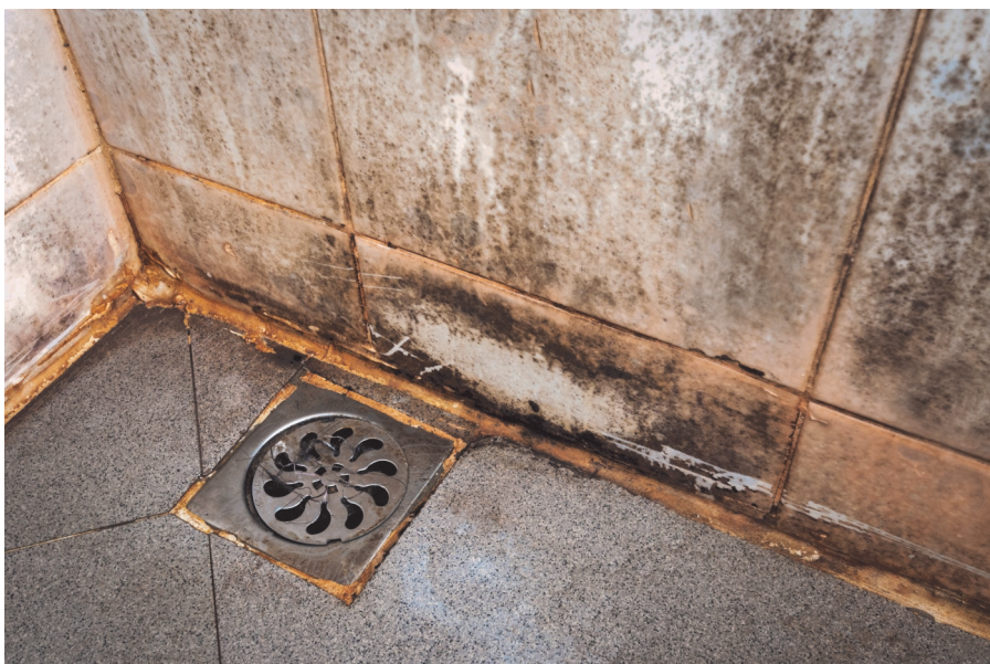
Schimmelbefall in einem Bad in welchem nicht darauf geachtet wurde, die Feuchtigkeit zu entfernen.
