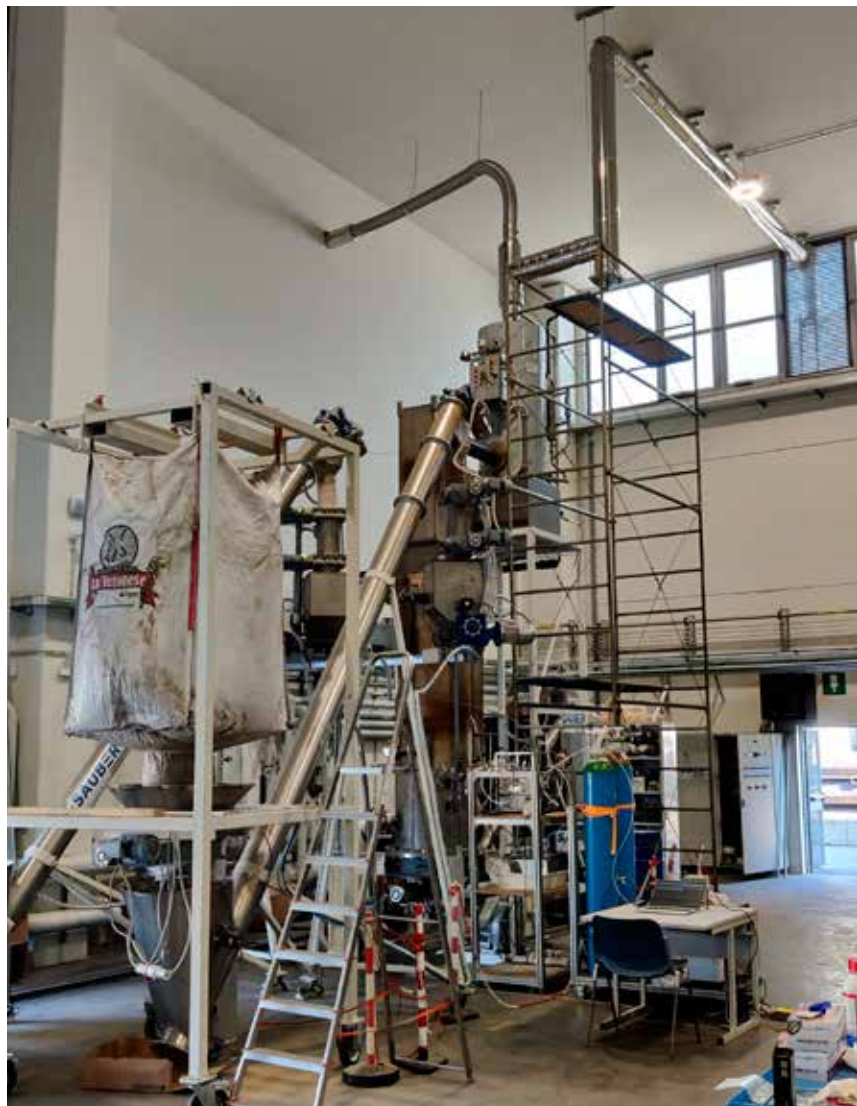
Abb. 1: Der im Bioenergy & Biofuels LAB der unibz installierte Aufwindvergaser (SAUBER).
