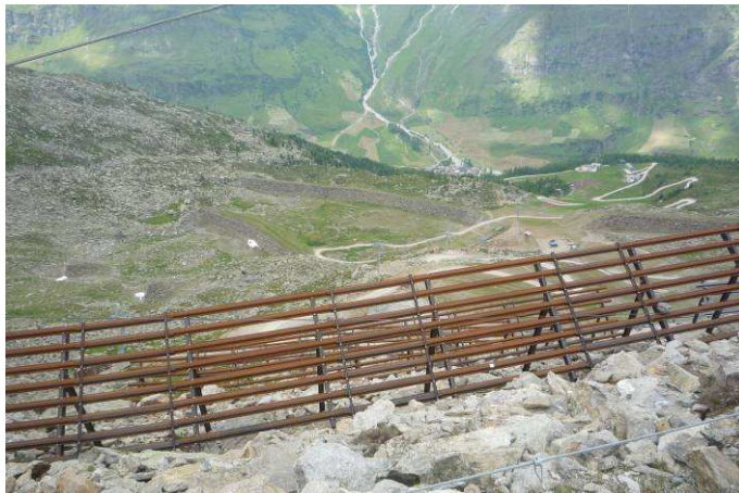
13.3 Lawinenverbauungen - Opera paravalanghe
