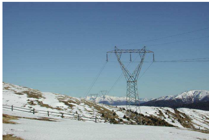
11.1 Elektrofreileitungen – Linee elettriche aeree
