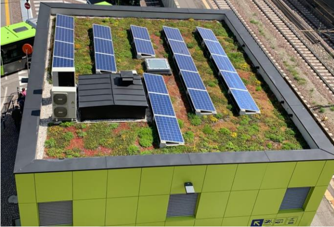
Kombination Photovoltaik - Gründach
