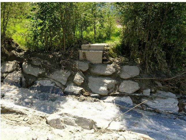
Abb. 4.16: Oben links: die verstopfte Holzbrücke hat zur Überflutung des Baches auf den umliegenden Wiesen geführt; oben rechts sind die Brückenpfeiler der Zufahrtsbrücke zum Bergerhof zu sehen, die zusammen mit der Fußgängerbrücke in der Nähe der Mündung in den Pfitscherbach (links) von der Mure weggerissen wurde;
