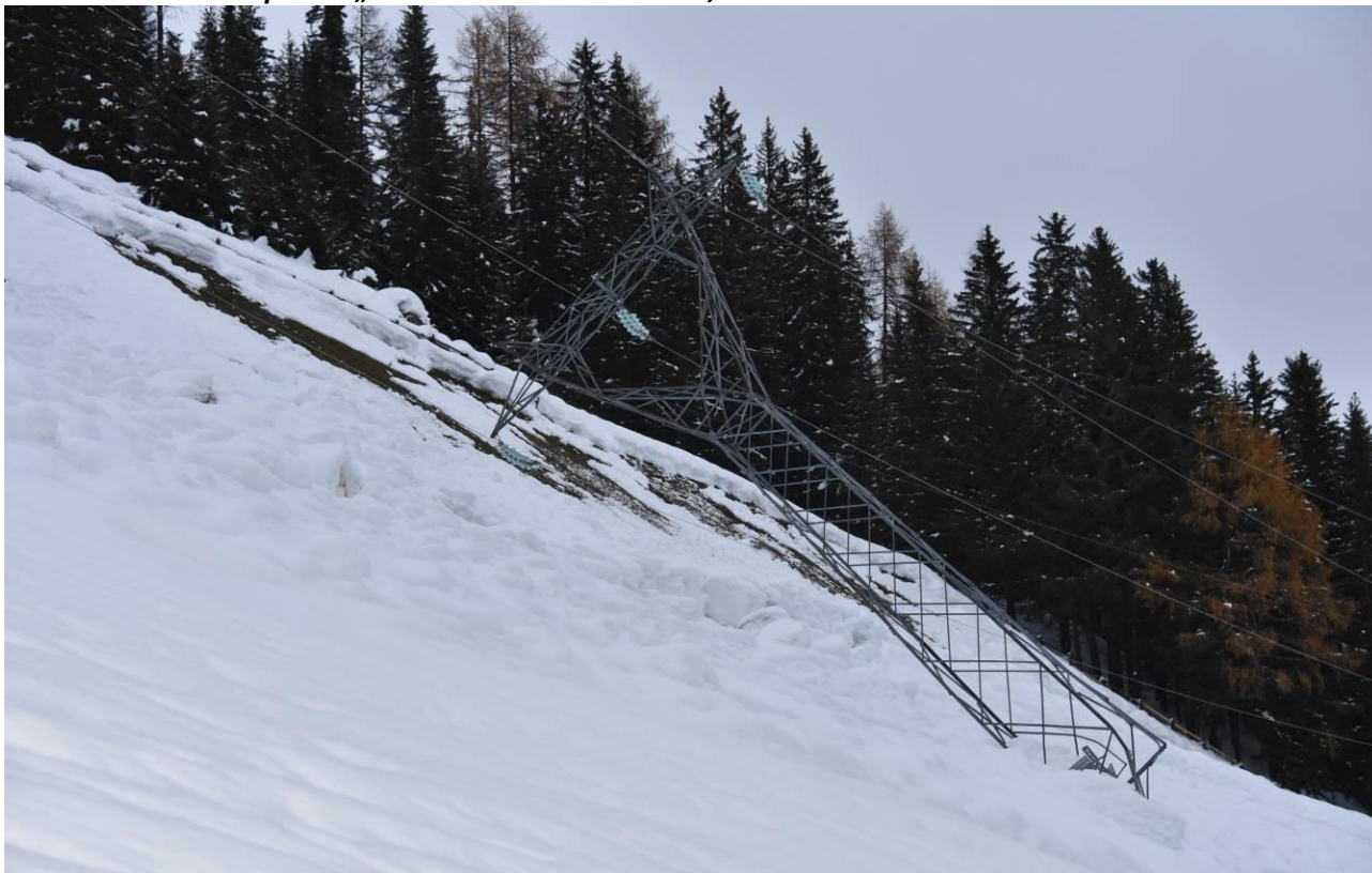
Figura 62: traliccio abbattuto da uno slittamento di neve nei pressi del maso Öberstein
