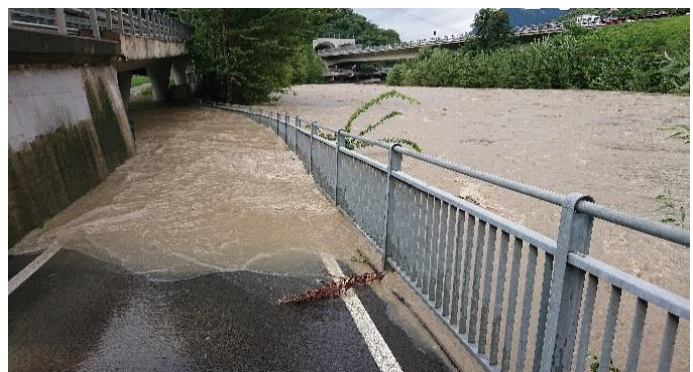
Figura 9: A sx danni spondali sull'Isarco presso Ponte Gardena: A dx alluvionamento della pista ciclabile presso Cardano
