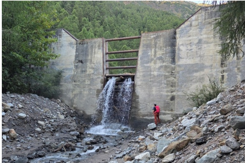
Figura 4.25 – Briglia filtrante posta a chiusura del piazzale di deposito
