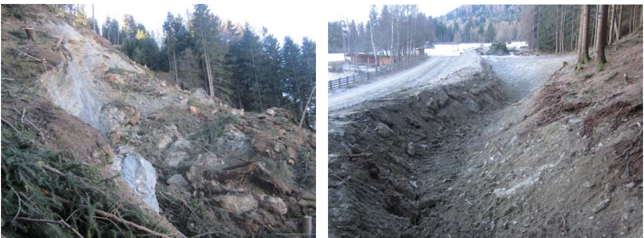
Figura 19: a sinistra la nicchia di distacco dello scivolamento in roccia che ha coinvolto sia la fillade quarzifera che il detrito di versante; a destra uno dei due valli paramassi costruiti al piede del versante, che a febbraio 2017 aveva già intercettato già numerosi blocchi
