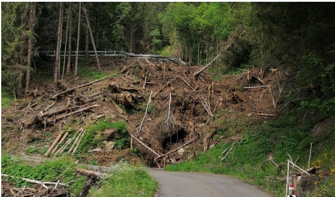
Abb. 6.18: Auch diese Lawine hat in diesem Winter zwei Mal die Gemeindestraße, welche zu den Höfen unterhalb der Matatzspitze führt, verschüttet. Im Bild die auf 20 m weggerissene Leitplanke der Gemeindestraße und viel Lawinenholz.
