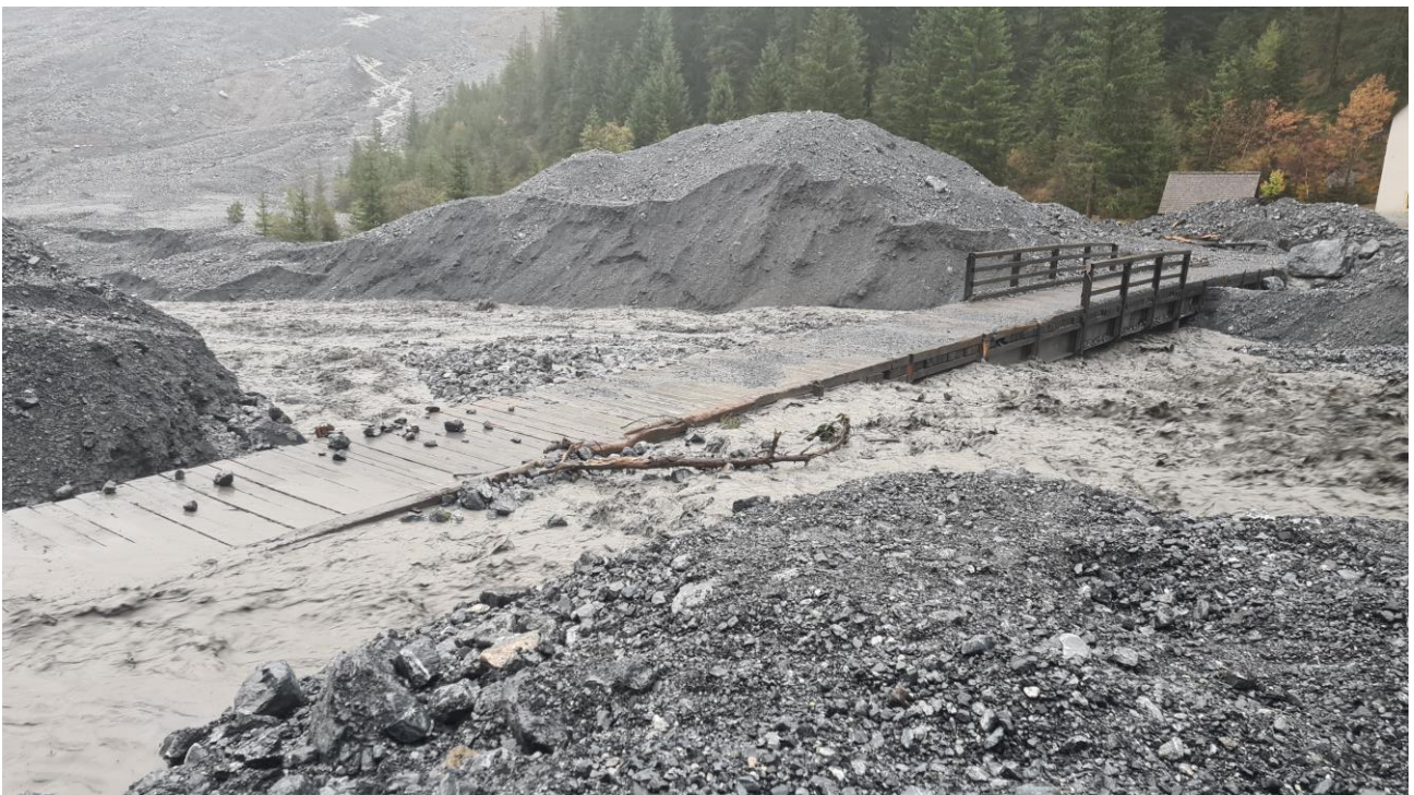
Abb. 4.20: Am 20. Oktober hat ein weiteres Wetterereignis die Remobilisierung des Materials und einen neuen Schaden an der Brücke verursacht
