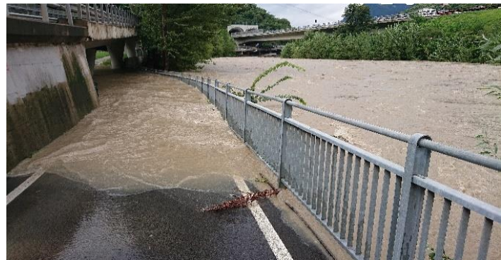
Abb. 9: Links Uferschäden am Eisack bei Waidbruck; Rechts Überflutung des Radweges bei Kardaun
