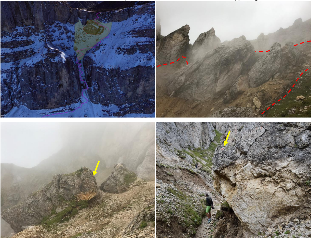
Abb. 33: Links oben ein Ausschnitt aus Google Earth Pro 2020, modifiziert durch das schreibende Amt. In Gelb ist die von den Hangbewegungen betroffene Fläche dargestellt, rot umrandet die instabile Blockmasse, welche die Felssturzgefahr darstellt, sowie in violett der Steig Nr. 6 durch die Panascharte. Rechts oben ungefähre Abgrenzung der Massenbewegung. Erkennbar die deutlichen Bewegungsspuren, Zugrisse und offene Klüfte sowie die zerlegte, instabile Blockmasse. Links und rechts unten im Bild die instabile, abgerutschte Blockmasse, welche in Bewegung geraten ist. Man beachte die Markierung (gelbe Pfeile), die aufgrund der Kippbewegung nun etwa 2-3 m höher liegt
