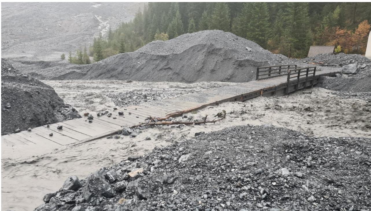
Figura 4.20: il 20 ottobre un altro evento meteo ha provocato la rimobilizzazione del materiale ed un nuovo danno alla passerella
