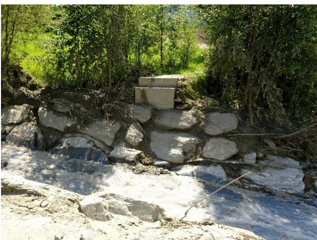
Figura 4.16: in alto a sinistra il ponte di legno occluso ha provocato l'esondazione del rio sui prati circostanti; in alto a destra si vedono i piedritti del ponte di accesso al maso Berger, divelto dalla colata insieme alla passerella pedonale prossima alla confluenza con il Rio di Vizze (a sinistra);
