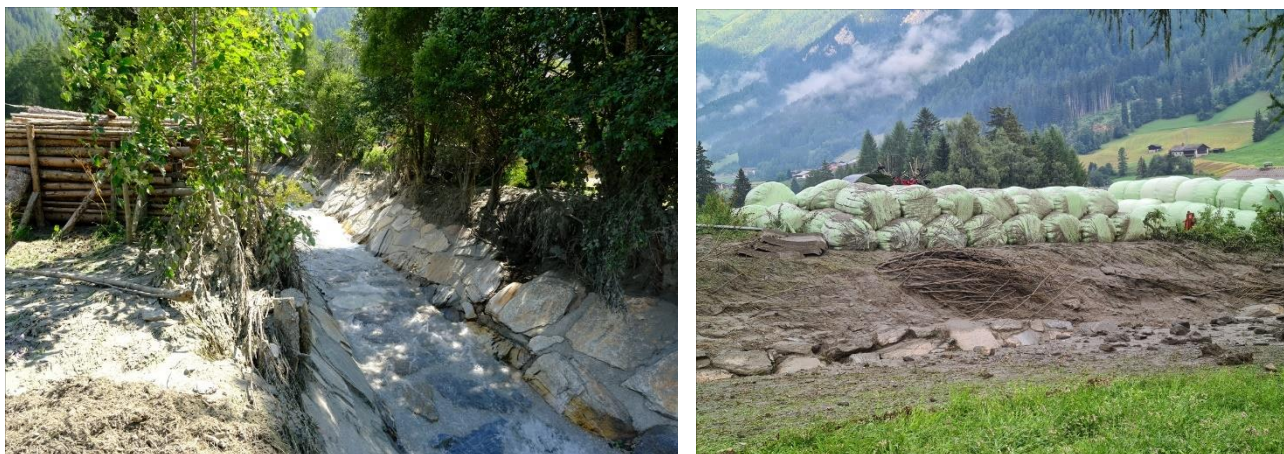
Figura 4.17: il deposito di legname o materiali nelle aree prossime agli alvei è estremamente pericoloso, perché tronchi e balle di fieno possono provocare fenomeni di occlusione ed esondazione con danni agli attraversamenti e alle infrastrutture.
