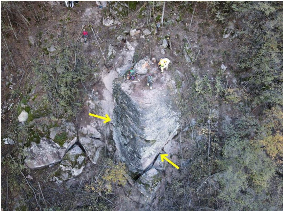
Figura 5.23: Foto aerea dello sperone roccioso esposto con un volume di circa 550 m 3 . Le fessure subverticali aperte (freccie gialle) nella roccia vulcanica sono chiaramente visibili nella parte inferiore dell'immagine.
